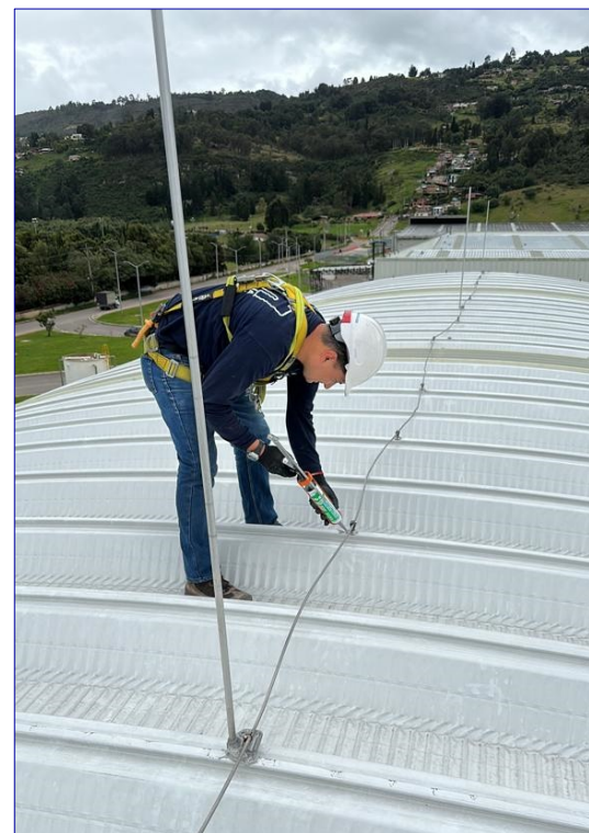
SISTEMAS DE PROTECCIÓN ANTE DESCARGAS ATMOSFÉRICAS
